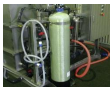
イオン交換樹脂 溶解装置用純水供給
