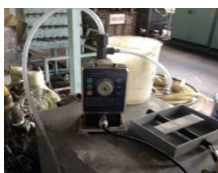
NSD型 洗浄水中和剤の注入
